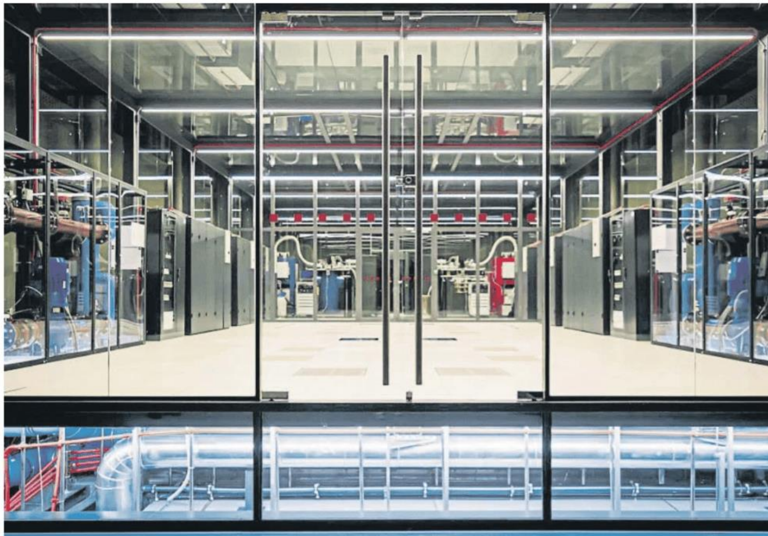
Espacio de la capilla de la Torre Girona, en el recinto de la UPC, en el que se instalará la maquinaria de la AI Factory
